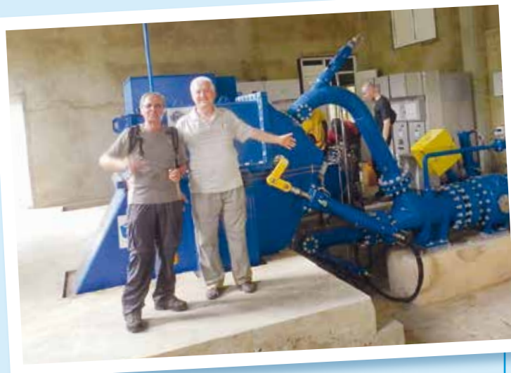
Vito Salvetti e p. Gianni Piccolboni vicino alla turbina della centrale idroelettrica
